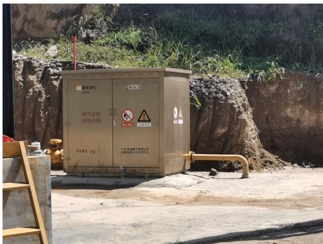
天然气调压柜
